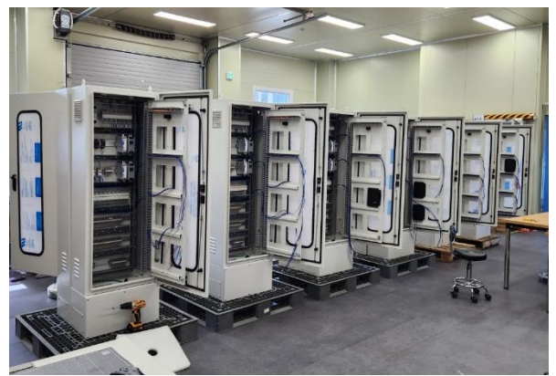
삼성디스플레이 LEAK CONTROL PANEL
